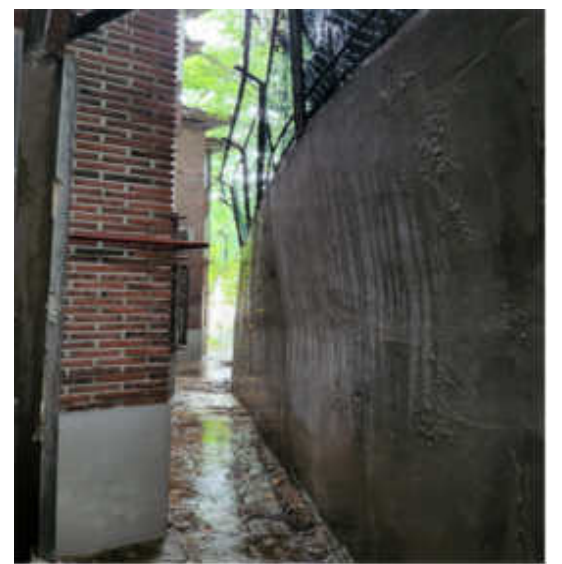
붕괴 옹벽 측면
