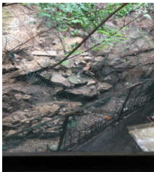
붕괴 옹벽 전면
